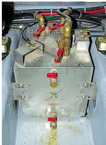
Die Motoren ziehen den nötigen Brennstoff aus dem Tagestank
